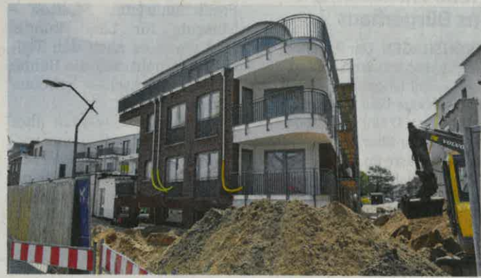
Nach den Pflasterarbeiten vor den Gebäuden an der Hafenspromenade wird auch der Bauzaun verschwinden.
